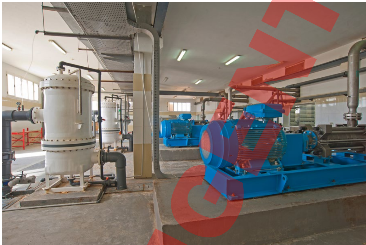
Figura 7. Sistema modular de bombas centrífugas para la osmosis inversa
